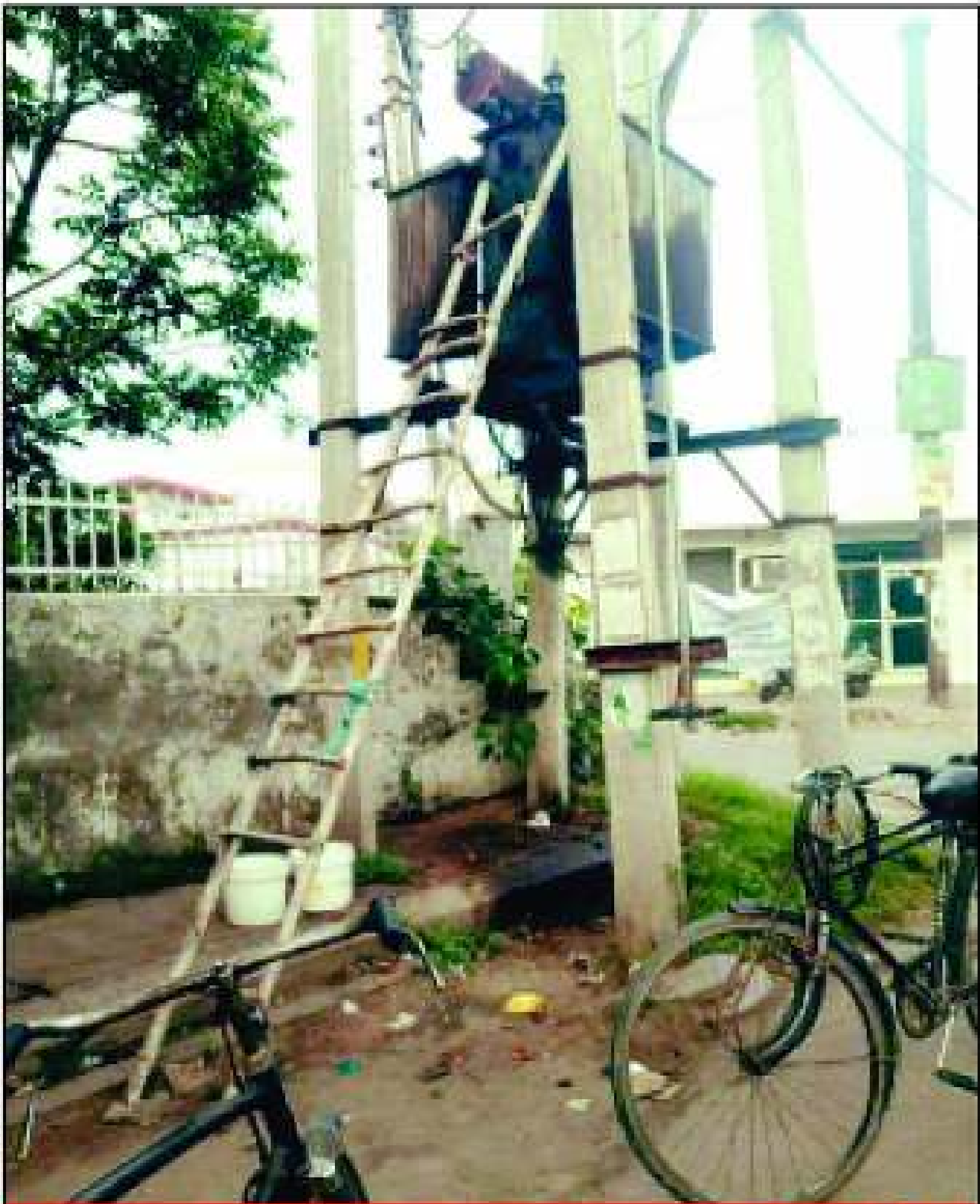
कम कपेसटी वाला खराब पड़ा ट्रांसफार्मर
